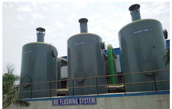
Advance flushing treatment at TTP, Surat
